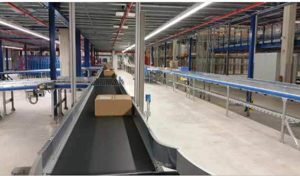
Die Materialbewegungen auf den Förderbändern im Logistikzentrum von Henry Schein werden über das angebundene SAP-System gesteuert.
